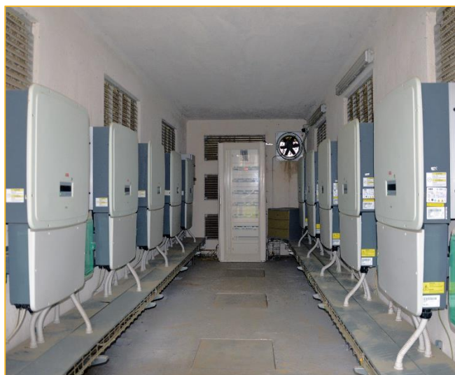
Fotografia 3. Pomieszczenie z falownikami
